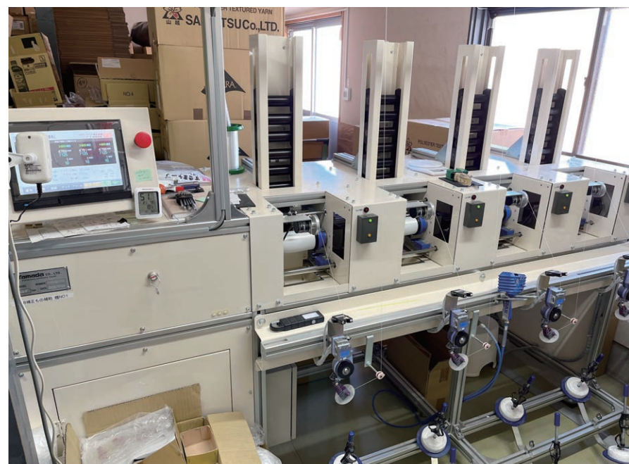
導入した設備
